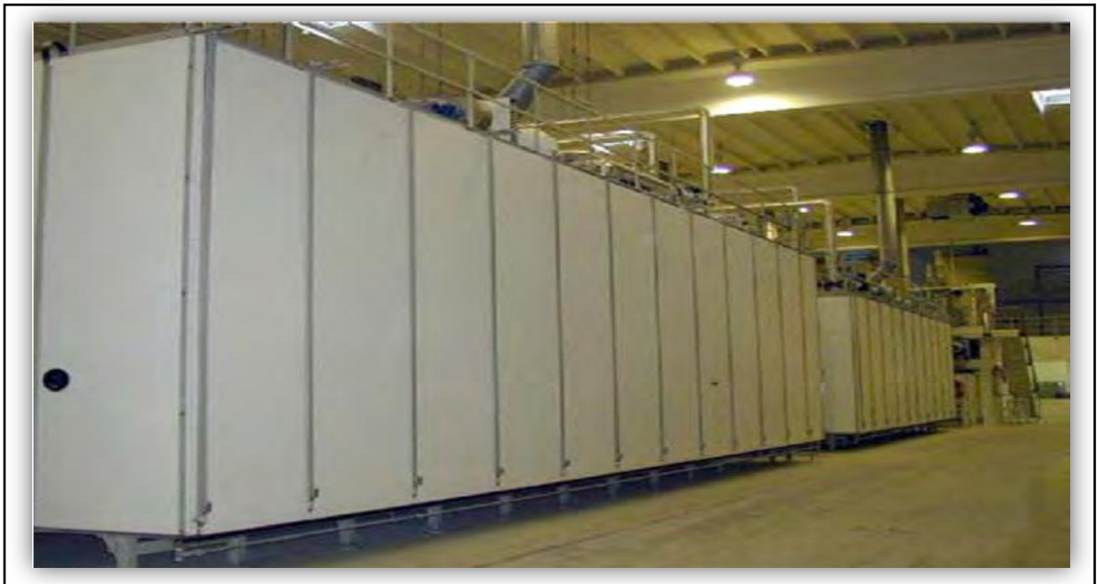
Figure 1.8. Tunnel de séchag.
