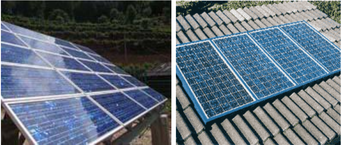
Figure 1.2: Exemples de champs de modules photovoltaïques
