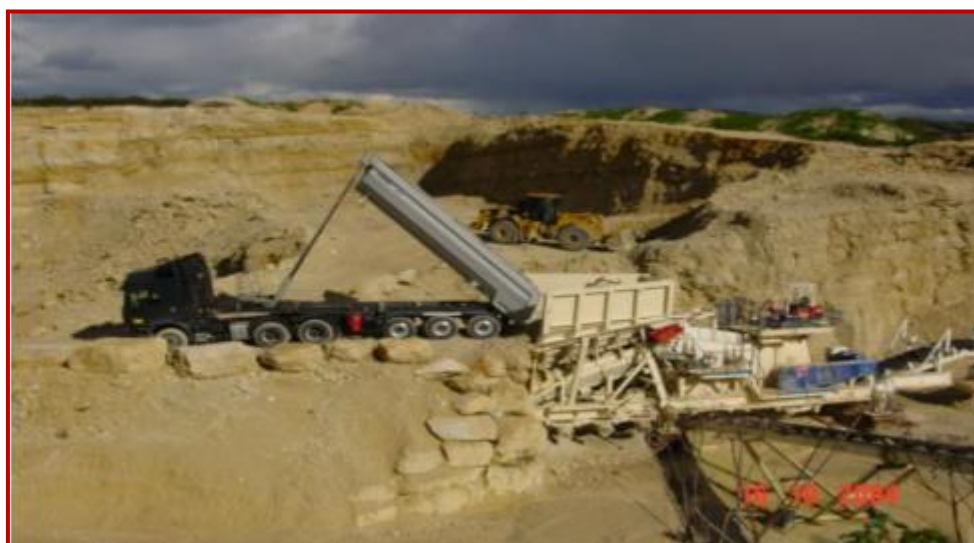
Figure 1.9 : Déchargement du calcaire dans le concasseur.
