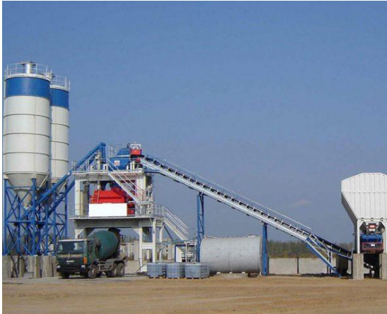
Figure5 : Centrale à béton fixe.
