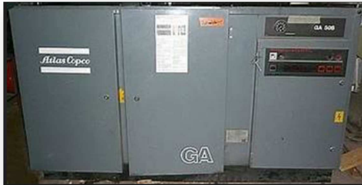
Figure II-12 : compresseur d'air comprimé.
