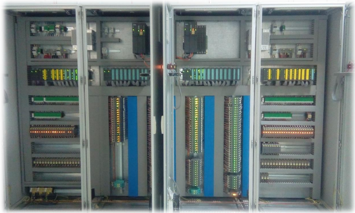
Figure III.3 : Vue interne armoire API S7-400FH
