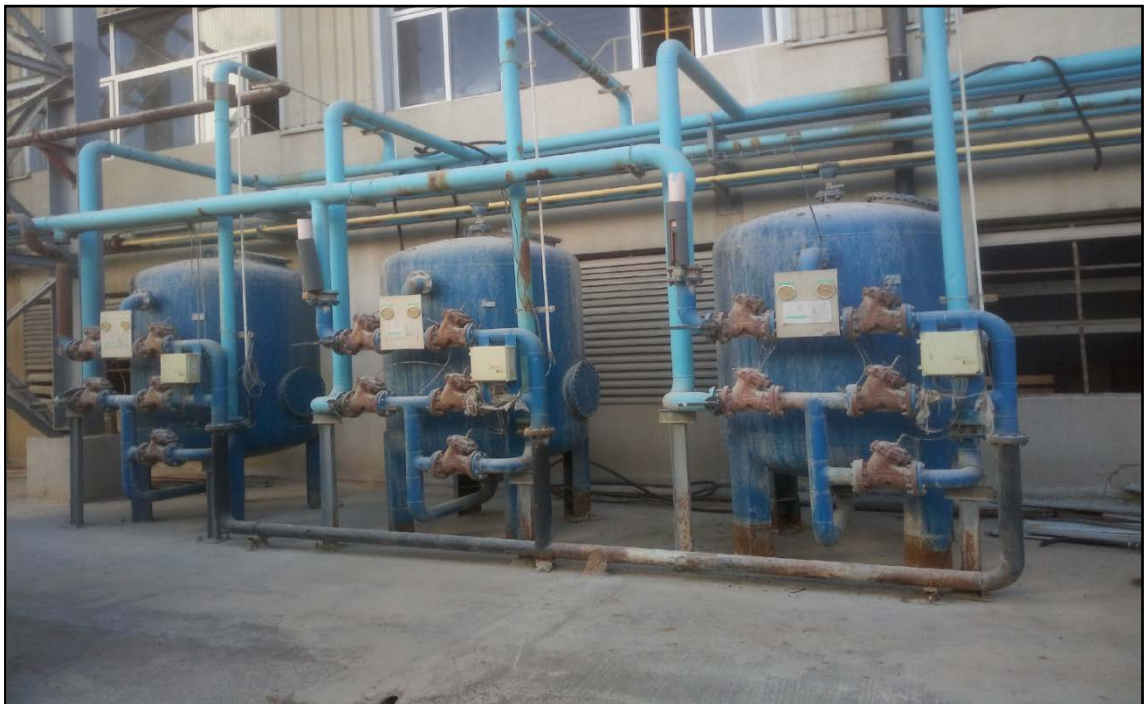
Figure2.4. Les filtres à sable.
