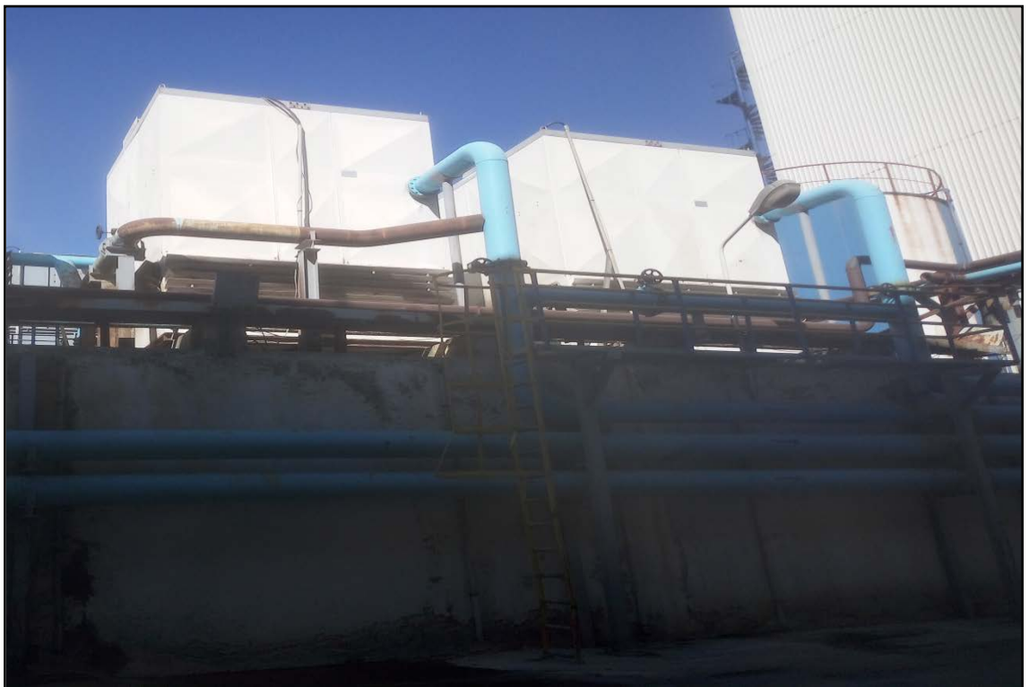
Figure2.6. Les tours de refroidissements ouvertes.
