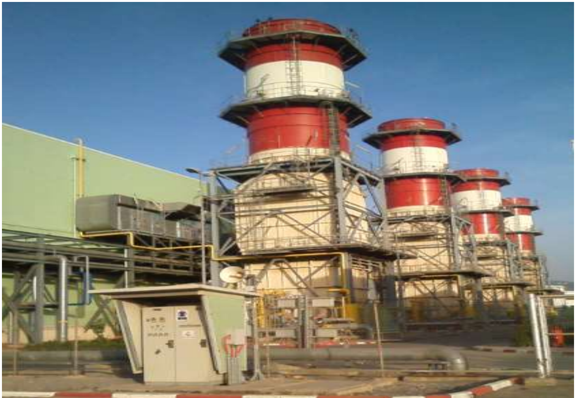
Figure 1.4. Centrale turbines à Gaz de L'Arbâa (4 X 140M)
