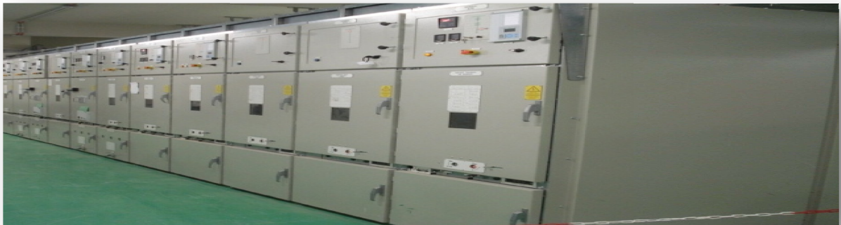
Figure 2.7 Tableau moyenne tension (MT) 6 kv
