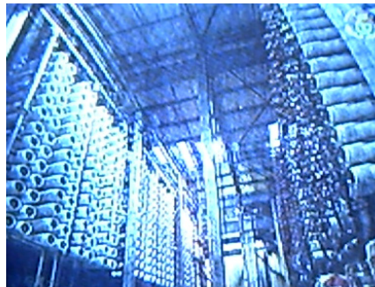
Photo JT ENTV du 25/02/2008 Bâtiment à l'intérieur de la station
