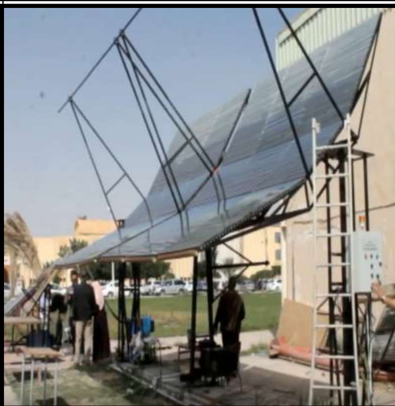
Fig.26: Installation solaire rotatif qui permet de réchauffé l'eau (énergie verte)
