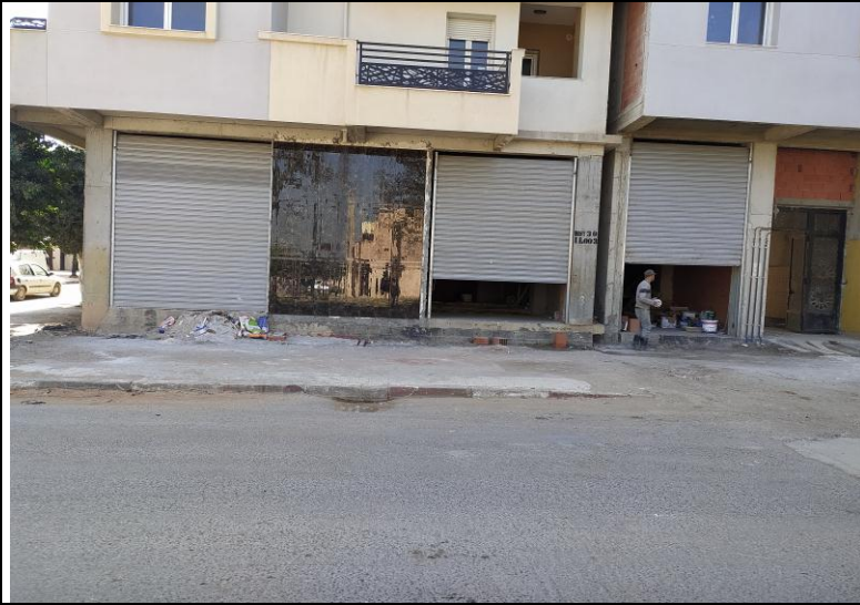
Fig. 25 : façade non fini les (garage, trottoir, joint délimitation...)
