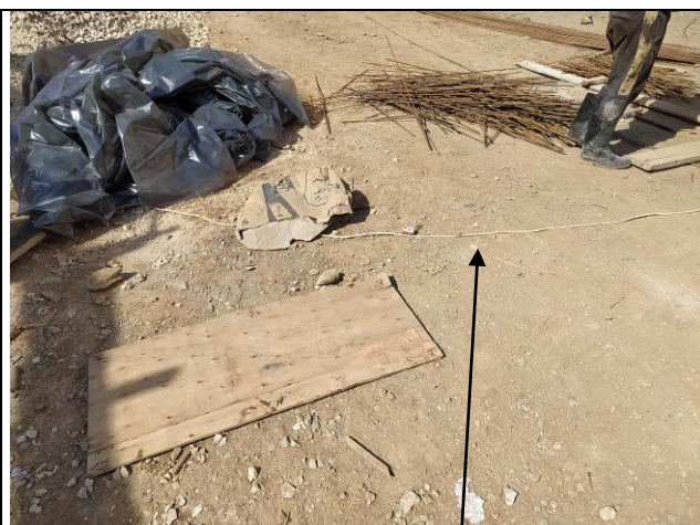
Fig. 23 : le manque de sécurité (câble d'électricité...)
