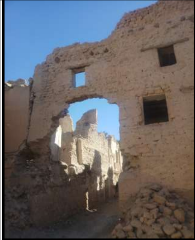
Fig. 11 vu a l'intérieur de ksar lychna qui est presque totalement délabré
