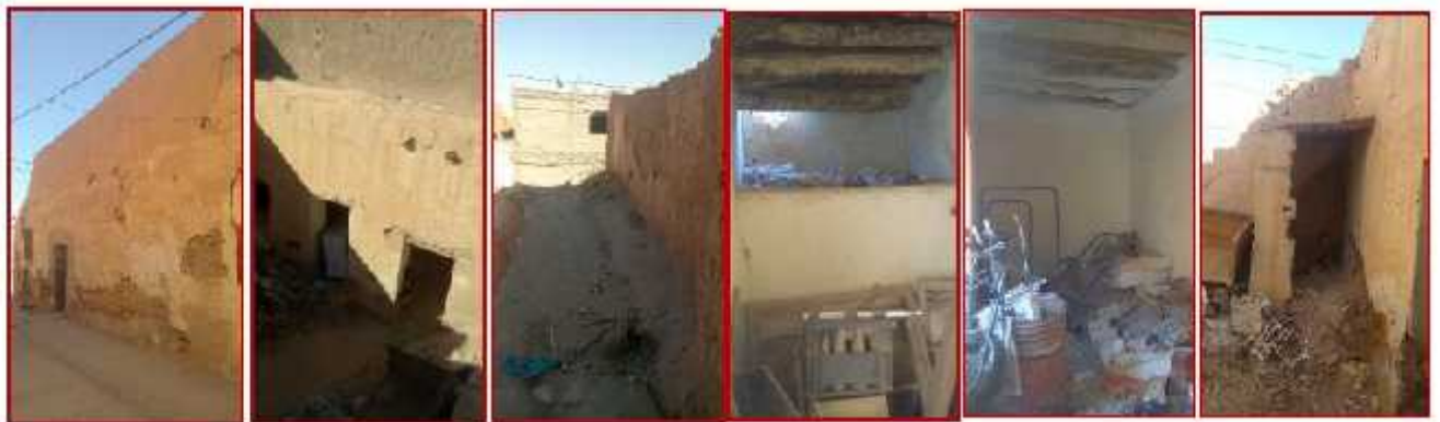
Figure 56: Maison en ruine sur l'axe d'intervention
