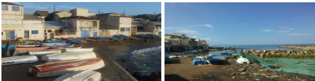
Figure 43 : état de dégradation au niveau de l'aire d'étude *Fouka marine* actuellement (source : auteur)
