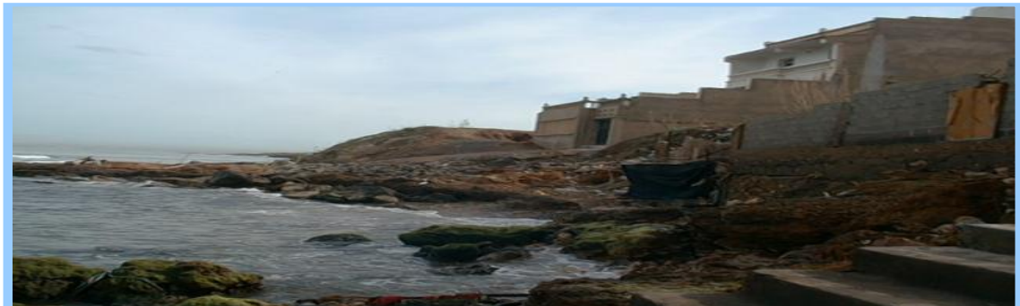
Figure 20: vue sur l'Éboulements par fragilisation de la zone côtière (source PDAU)
