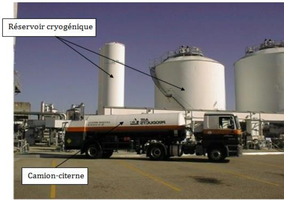
Figure 29 : Réservoirs cryogéniques et camion citerne.
