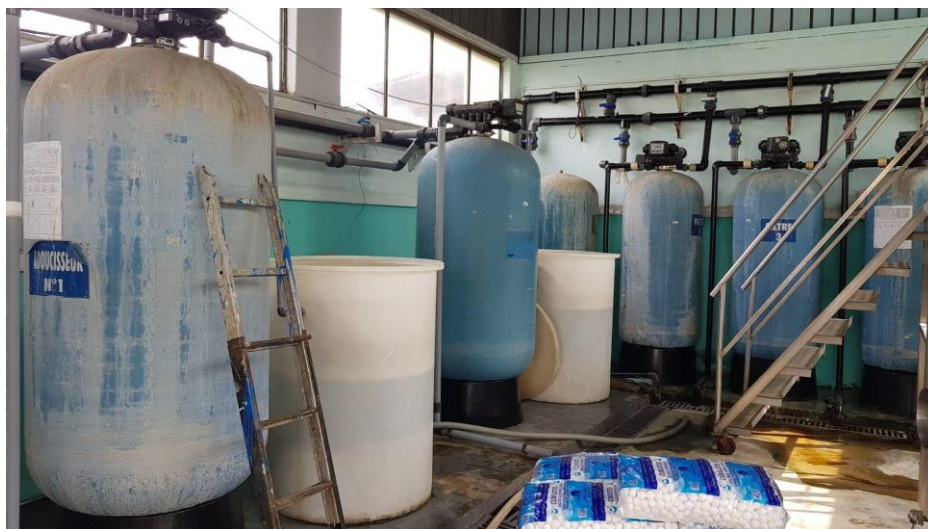
Figure 37 : les filtres de la station SMP.
