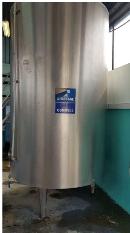
Figure 40 : cuve de stockage de l'eau osmosée.
