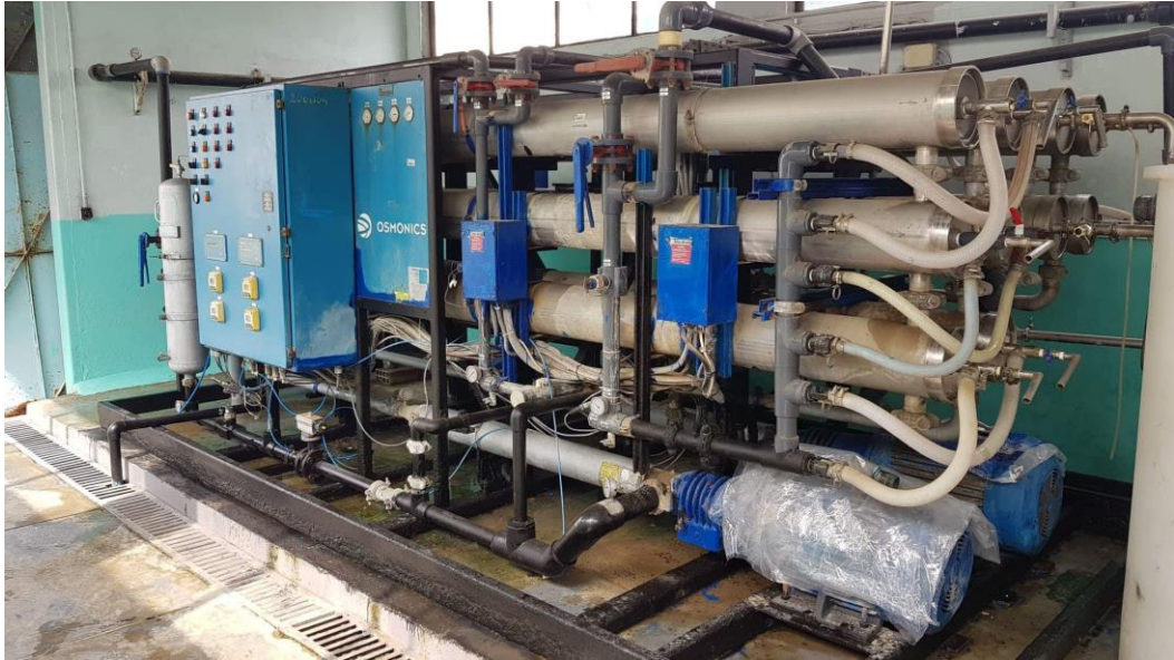
Figure 39 : une installation d'osmose inverse de la station SMP.
