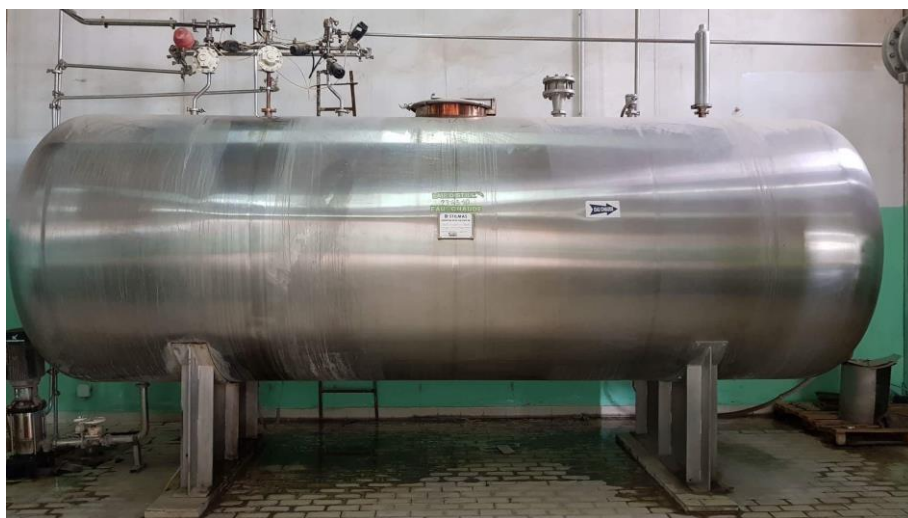
Figure 35 : cuve de stockage d'eau distillée.
