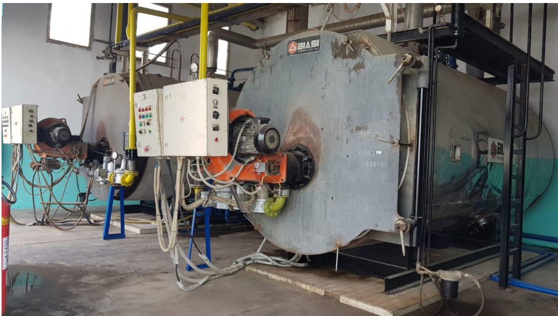
Figure 43 : chaudière industrielle de la station SMP.
