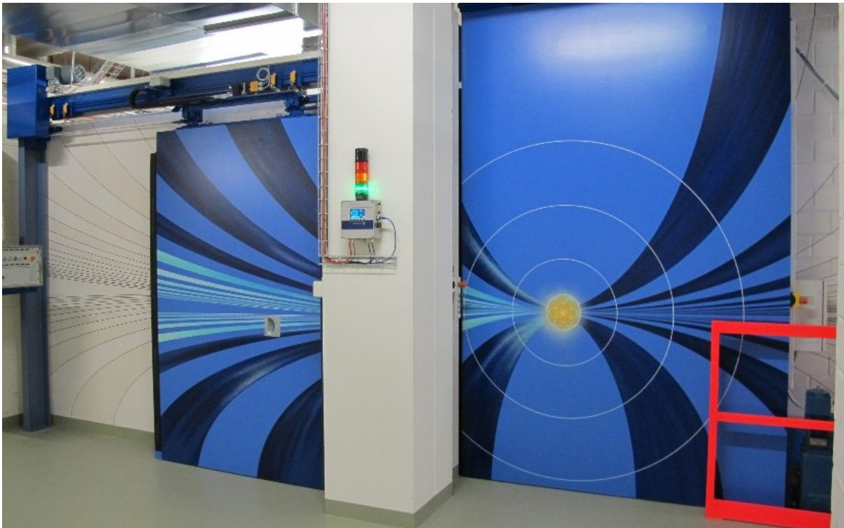
Figure II-3 les portes de radioprotection
