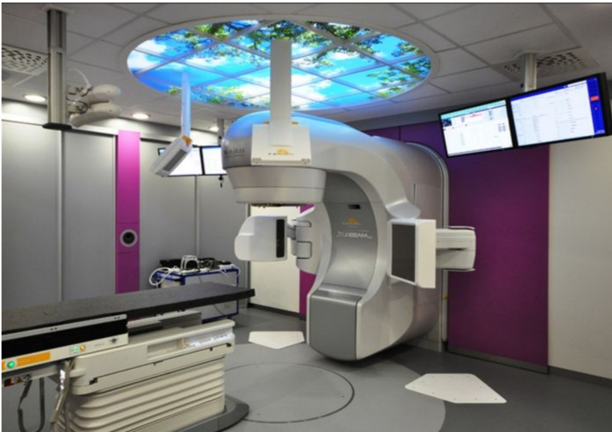
Figure II-2 Bunker équipé -Salle de radiothérapie
