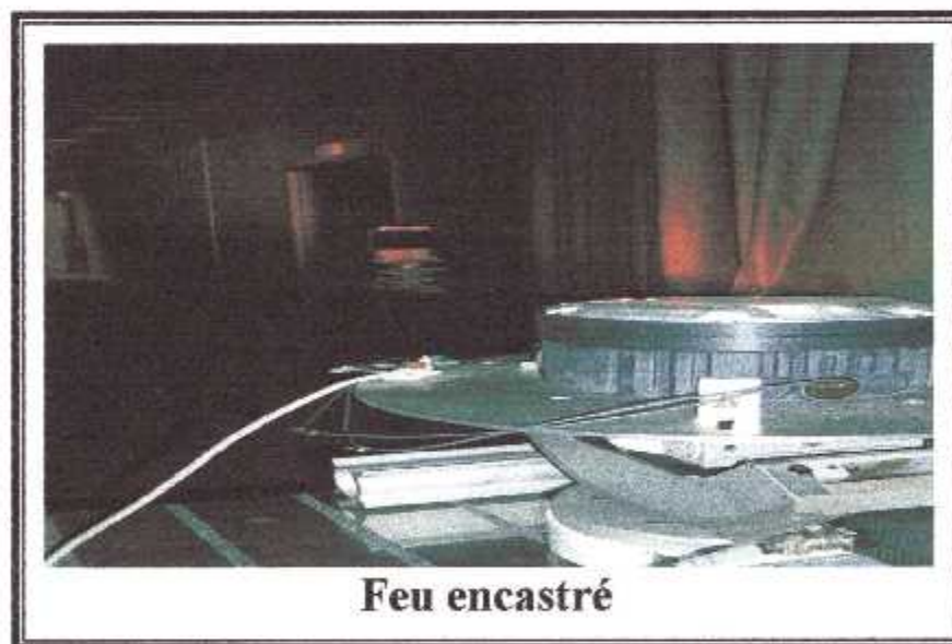
Fig. II-10 : Des exemples de feux
