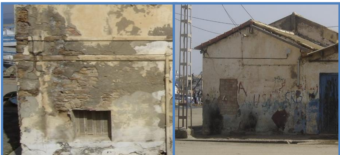
Fig 34 : Bâti en mauvais état Source : www.google/images.com
