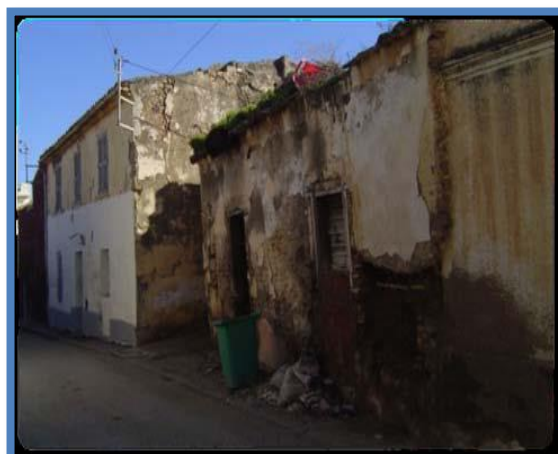
Fig 40 : Bâti en mauvais état Source : Mémoire fin d'étude
