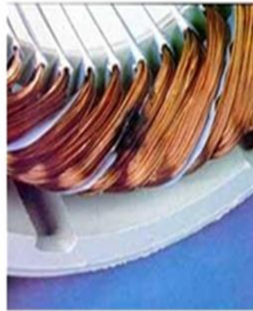
Court-circuit entre phase
