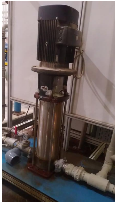
Figure II.12 : Pompes à eau
