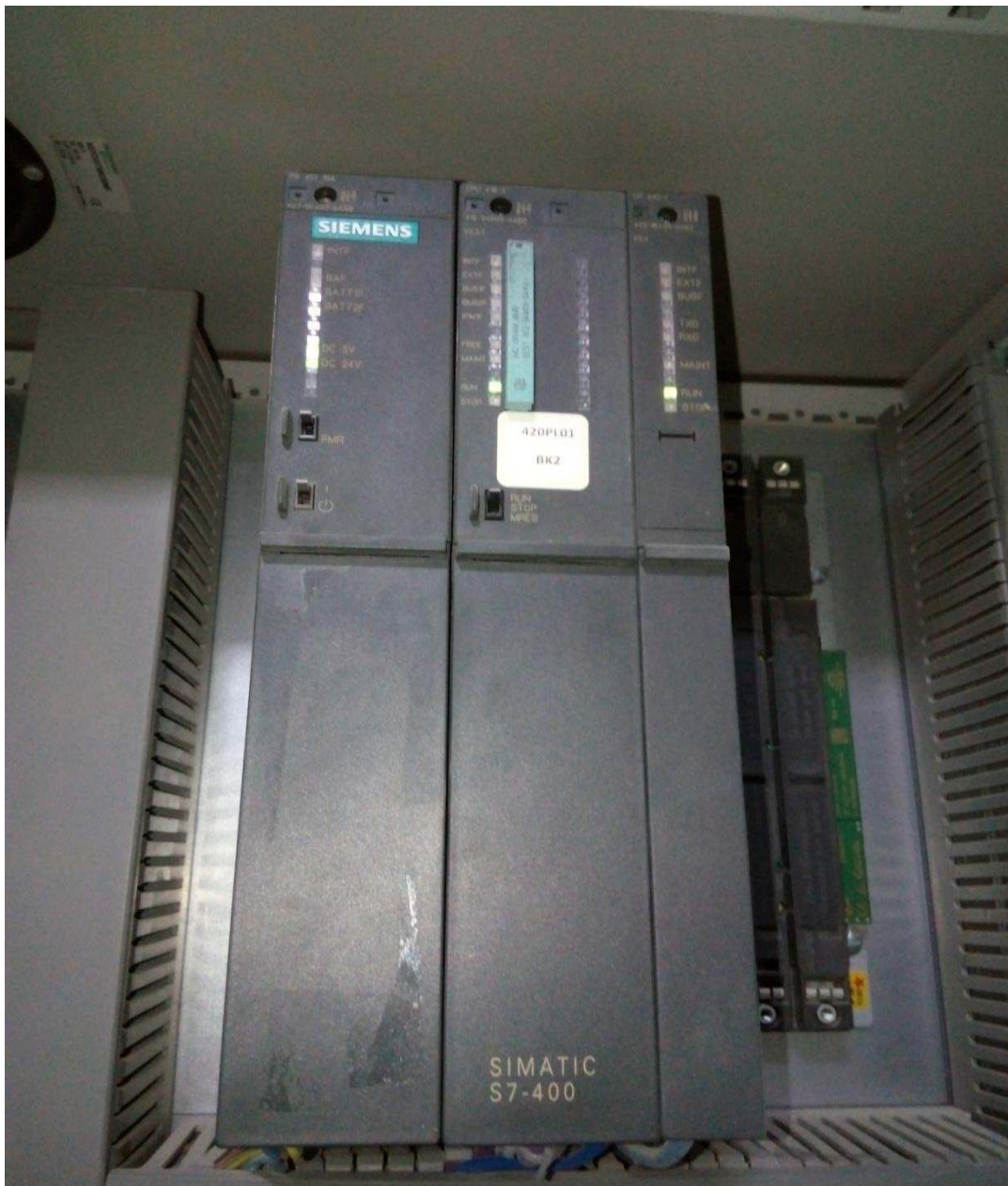
Figure34:Photos del'APIS7-400dans l'armoiredes APIàl'intérieurdeservice commande de la zone cuisson
