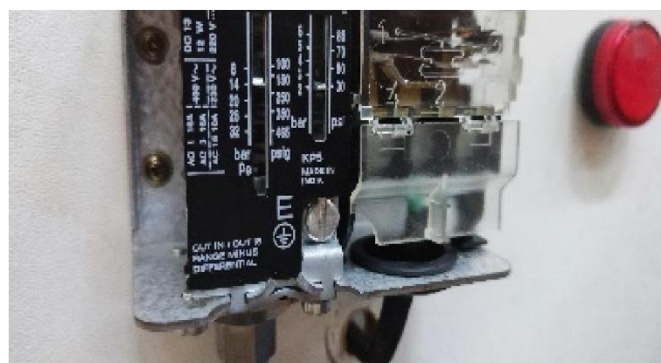
Figure (5.12) : Réglage de pressostat
