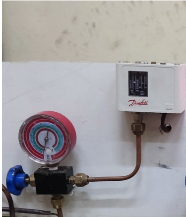
Figure 43 : La Vanne, Mano HP et Pressostat
