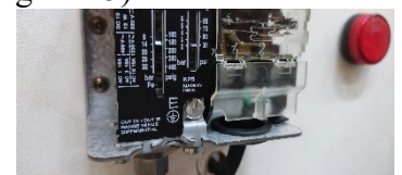
Figure 45 : Réglage de pressostat
