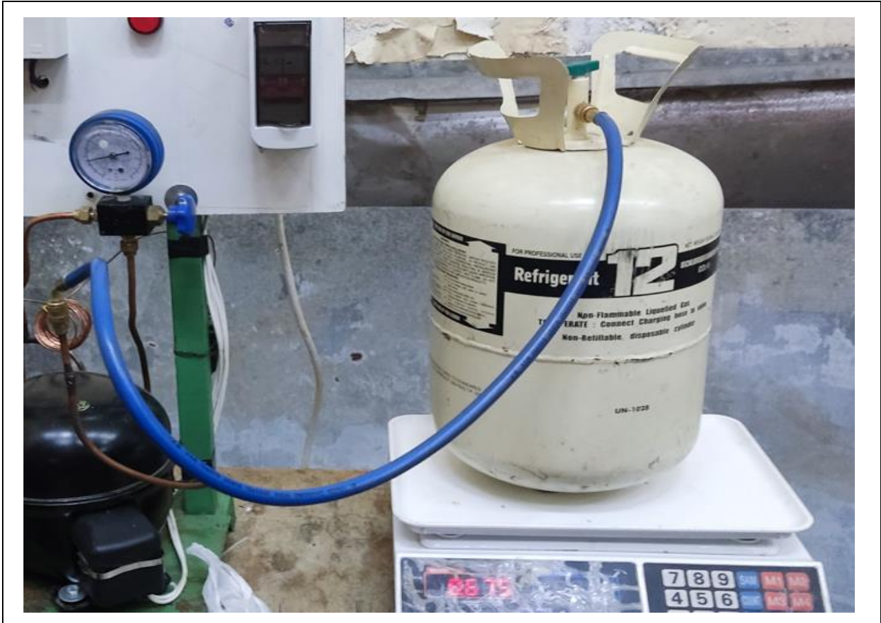
Figure 5-13 : Procédure de charge du fluide R12 dans le circuit.
