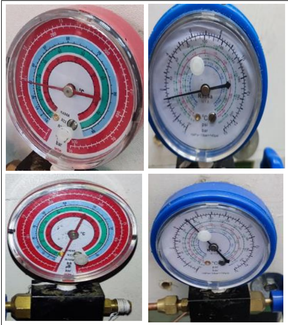
Figure 5-14 : Mise en marche des manomètres HP et BP.
