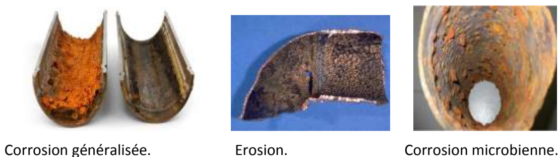
Figure 1.4 : Pertes de métal dues à la corrosion interne.
