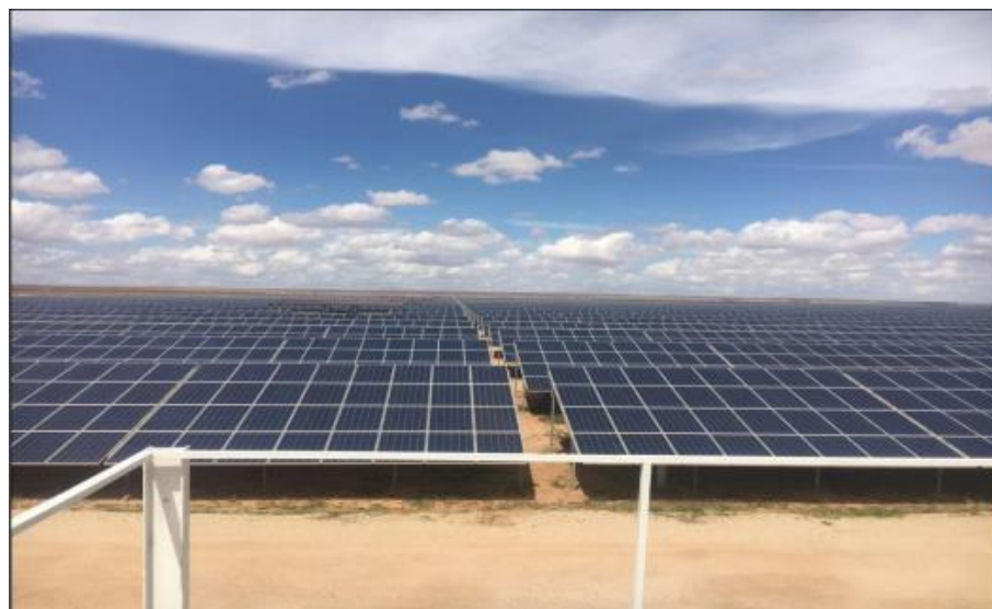
Figure 1. 29 Les champs photovoltaïques de la centrale d'Ain Skhouna.[44]
