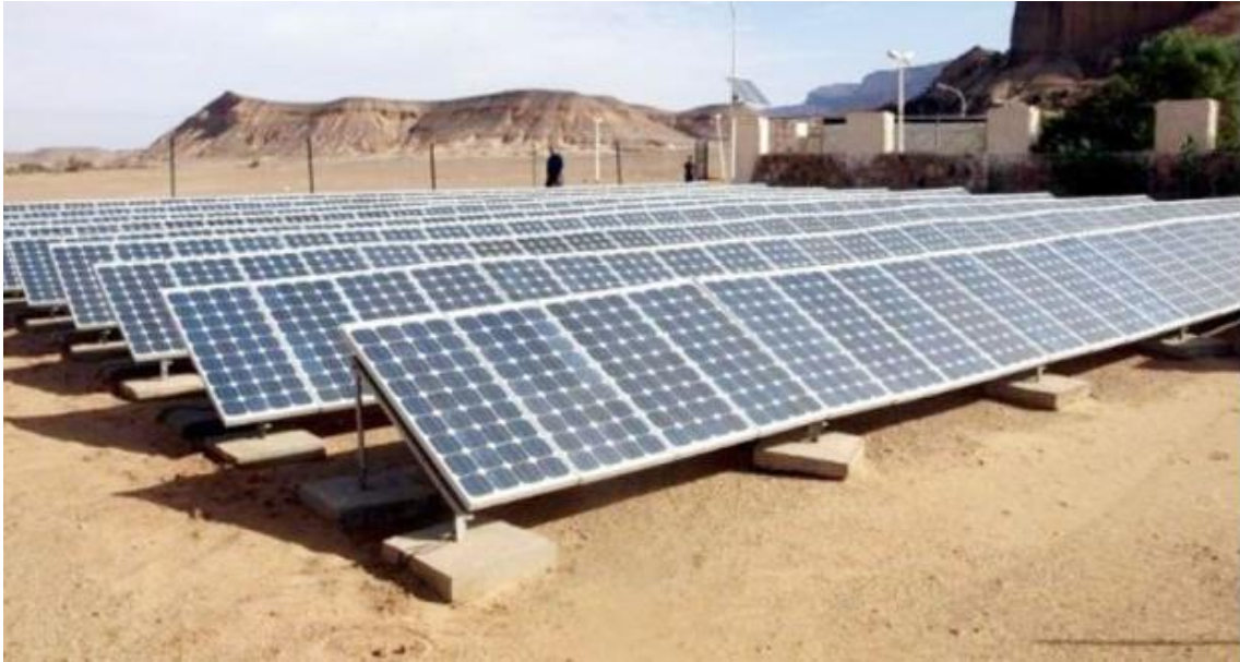
Figure 1. 30 Panneaux solaires centrale Ghardaïa.[47]
