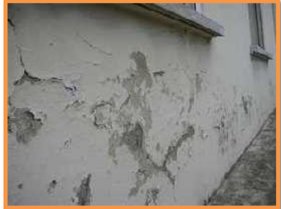
Impacte de l'humidité sur le mur
