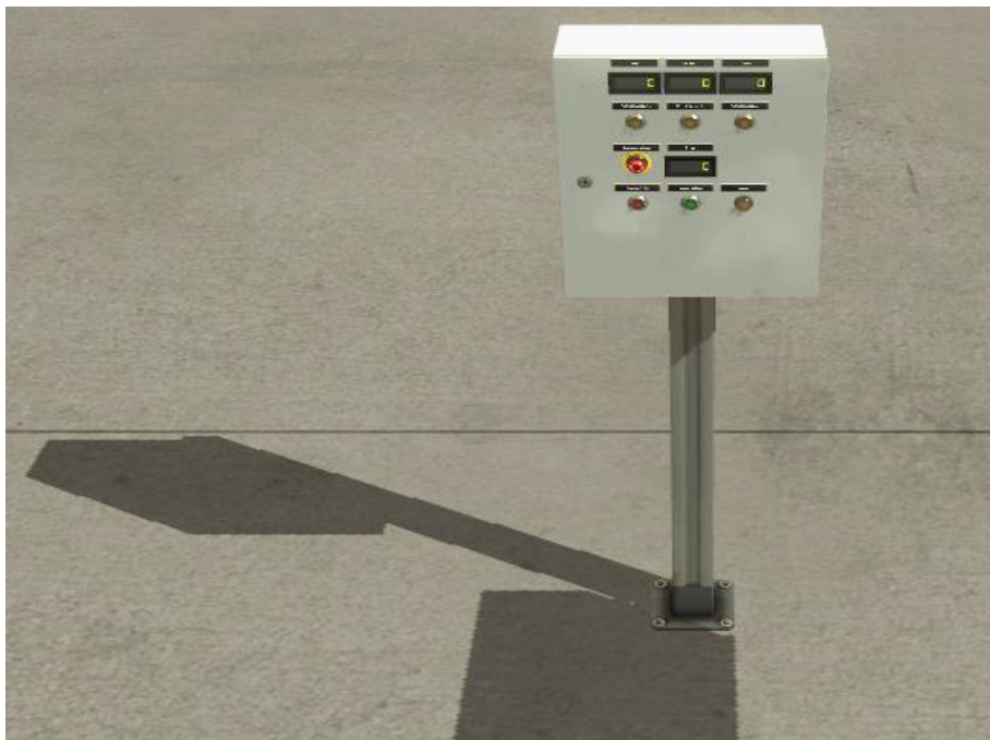
Figure 3.9 panneau de commande complète
