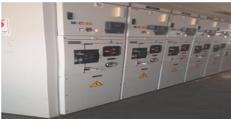
Figure (II.15) : Figure Poste d'évacuation de 30 KV
