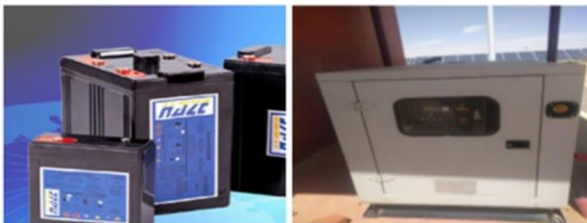
Figure (II.16) : Groupe diesel et batteries utilisés
