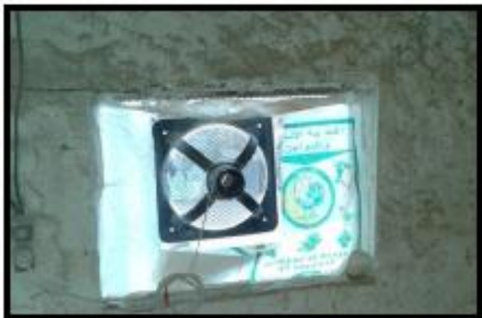
Figure 03 : photo d'un exemple de ventilation dynamique(photo prise personnellement)
