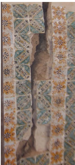
Fig 41 : une photo qui montre l'état dégradé de la céramique a l'intérieure de la mosquée KOUBBA EL KHADRA
