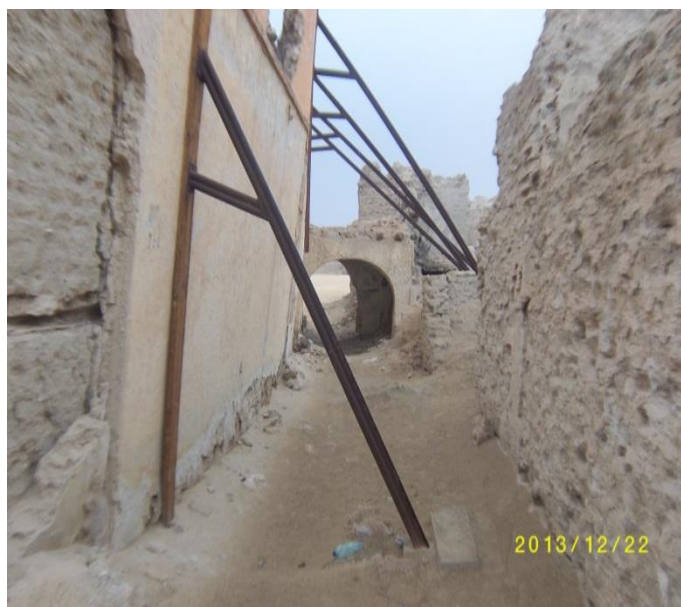
Fig 60 : une photo qui montre les travaux de l'étalement a l'extérieur sur la mosquée Koubba EL KHADRA en 2013
