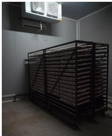
Figure 6 : salle de stockage des œufs à couvrir au niveau du couvoir.
