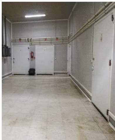
Figure 9 : Salle de transfert
