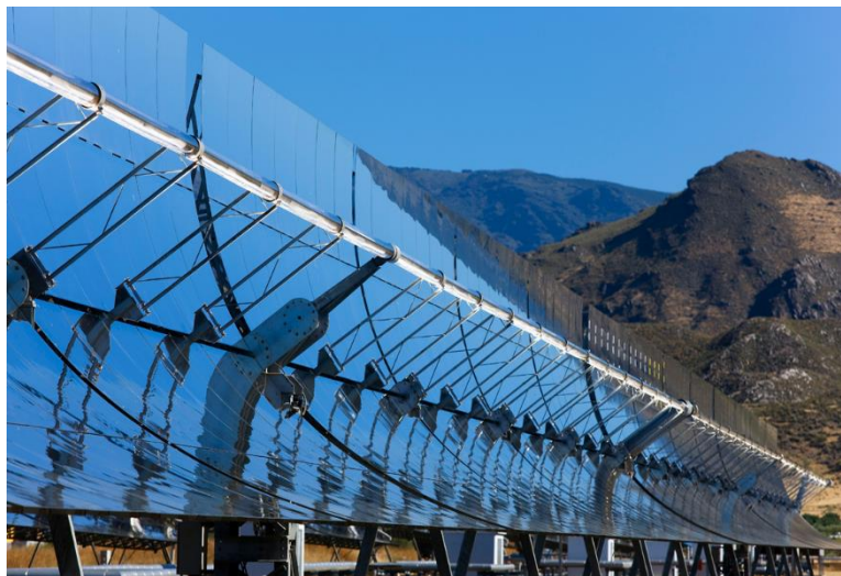
Figure III. 3: Centrale solaire à concentrateurs cylindro-paraboliques[23].
