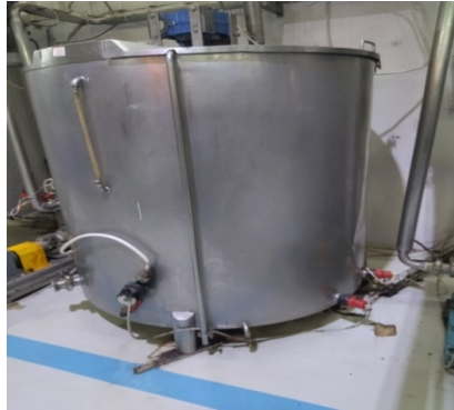
Figure 3-1 la cuve réel de stockage de chocolat existante au niveau de BIBILA [45]
