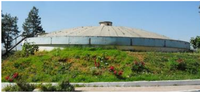
Fig.III 9. Réservoir de SP Tektaka 1000m 3
