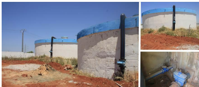
Fig.III 7. Réservoirs 2x500 m 3 de Chaïba
