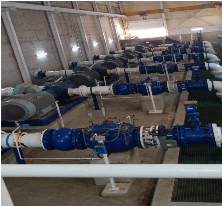
Figure III.13: Station de pompage d'eau traitée.
