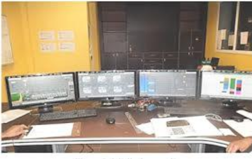
Figure III. 15: Salle de contrôle de la station de dessalement de l'eau de mer -Fouka-.
