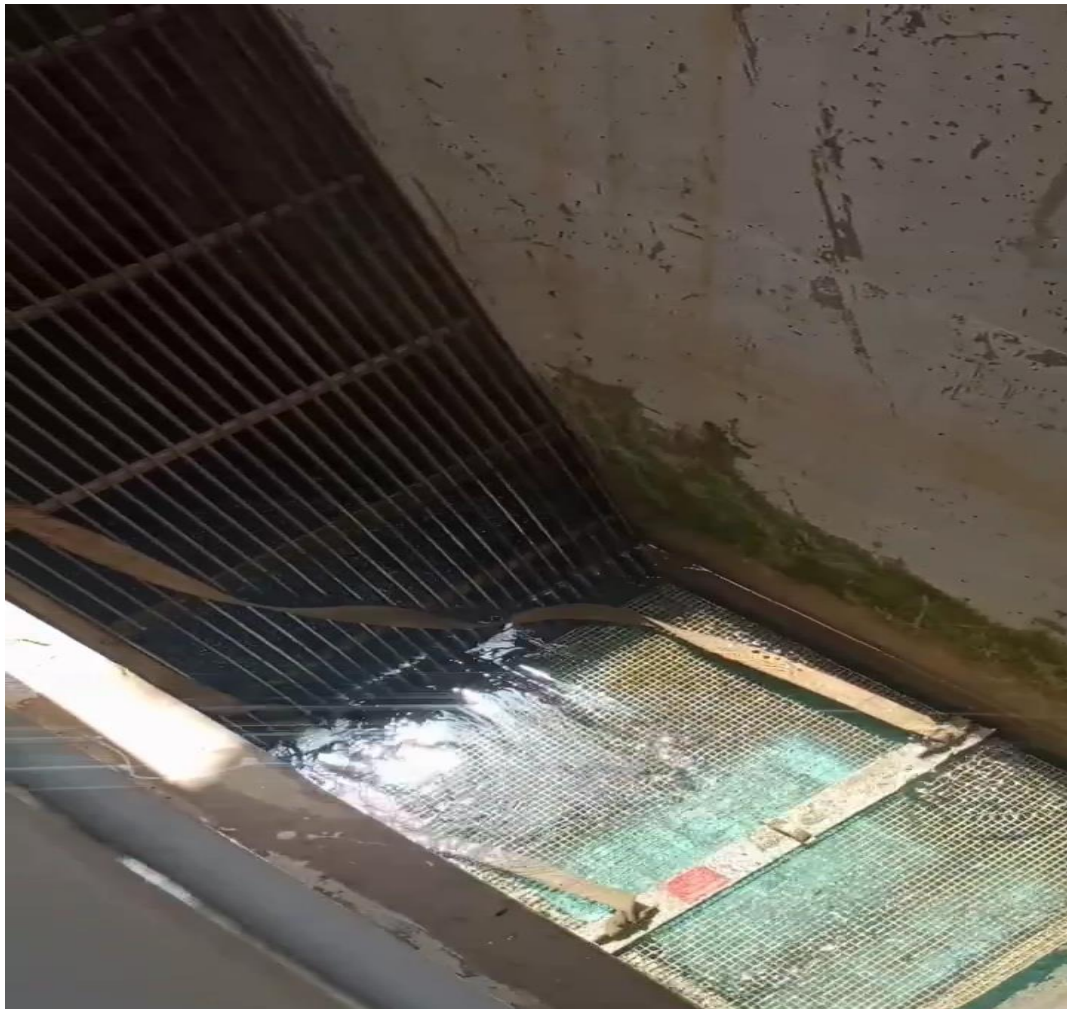
Figure III.6 : Les grilles de filtration manuelle.
