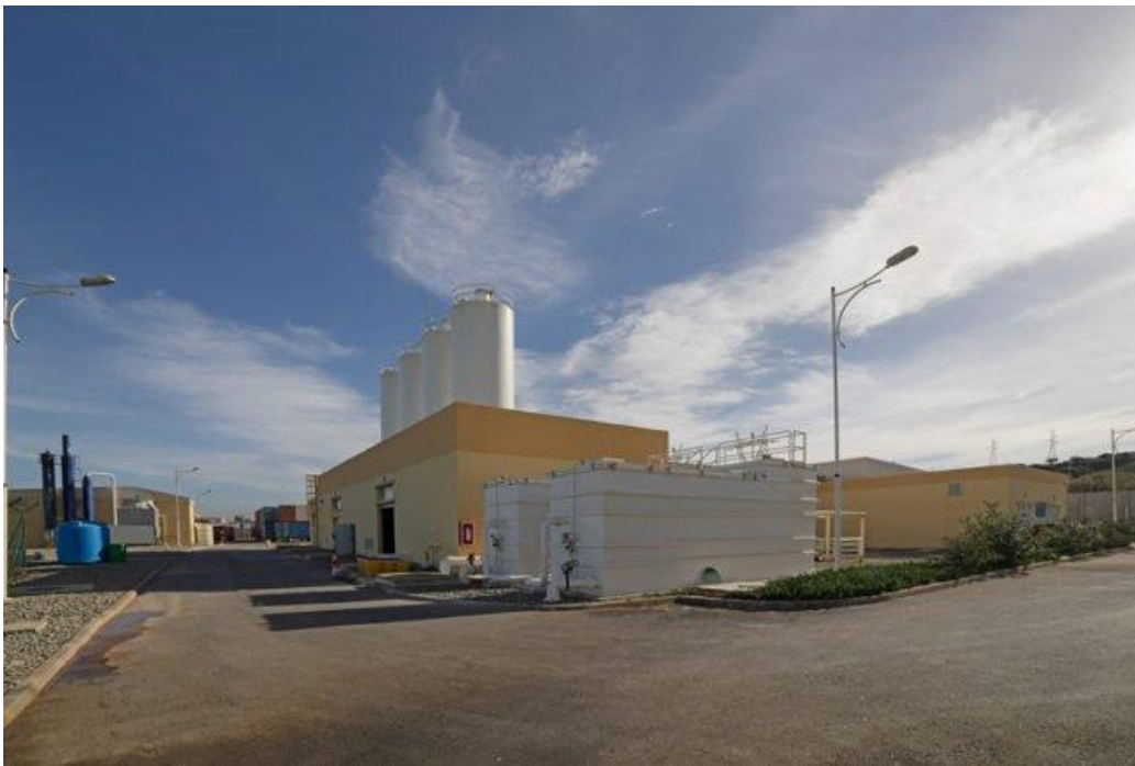
Figure III. 12: Le saturateur de chaux
