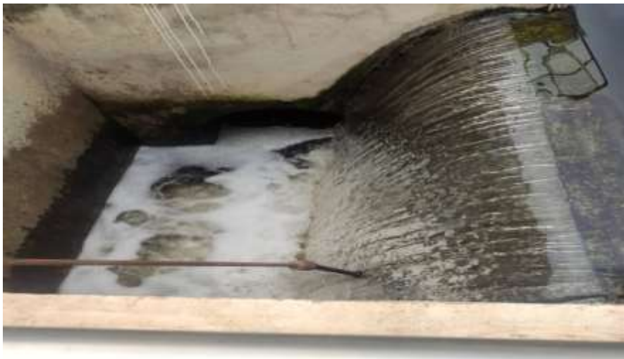
Figure III.13: Evacuation des eaux épurées Source : [STEP de Beni Mered]
