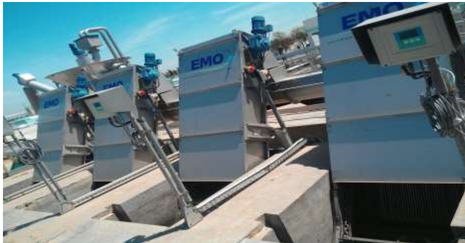
Figure III.3: Dégrilleur automatique fin Source : [STEP de Beni Mered]
