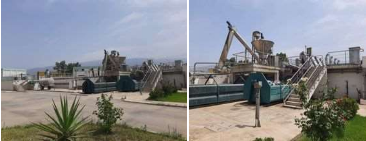
Figure III.4 : déssableur- déshuileur Source : [STEP de Beni Mered]
