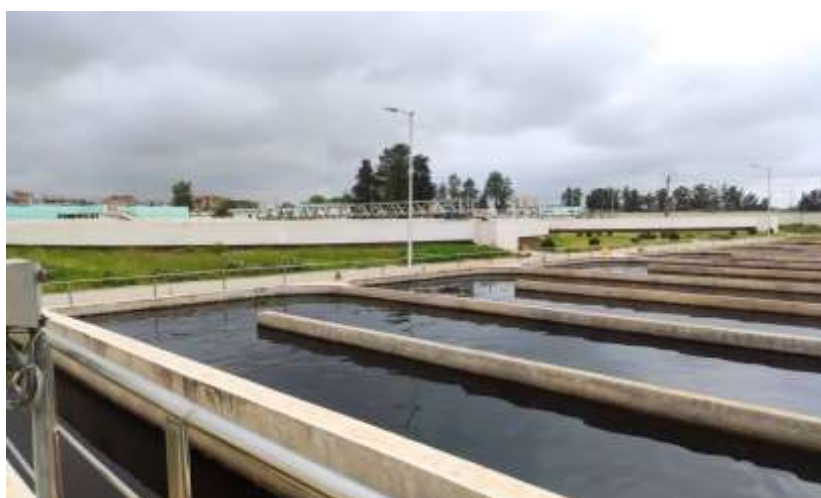
Figure III.11: Bassin de désinfection à chicanes Source : [STEP de Beni Mered]
