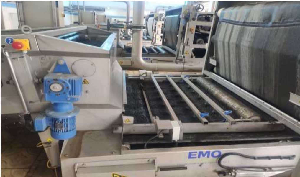
Figure III.14: Filtre à bandes paresseuses Source : [STEP de Beni Mered]
