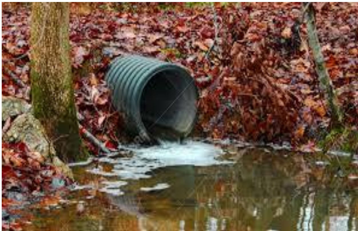
Figure IV. 1 un tuyau d'évacuation des eaux usées
