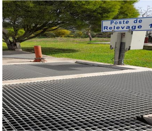
Figure 2: poste de relevage
