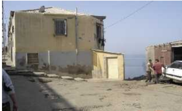
Image 113: Dégradation de bâti
