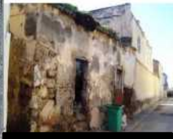
Image 91: Dégradation de bâti
