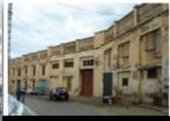
Image 90: Dégradation de bâti
