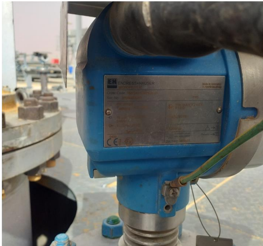
Figure 3.5 Plaque signalétique du LT radar (49-LT-0002).
