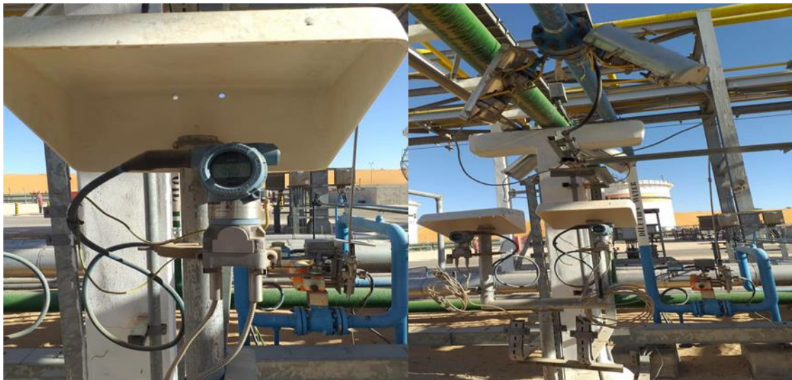
Figure 1.10 Transmetteur de débit.
