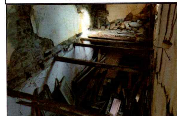
Fig.3.33- Dégradation du centre historique. Src : Auteur 2015.
