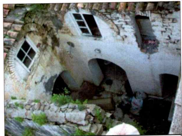
Fig. 1.11 Dégradation du tissu traditionnel de Dellys Source : Photos prises par le sous-groupe
