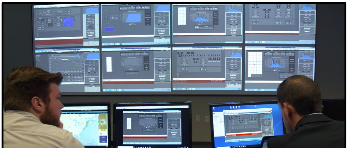
Figure 1.2 Salle de contrôle SCADA
