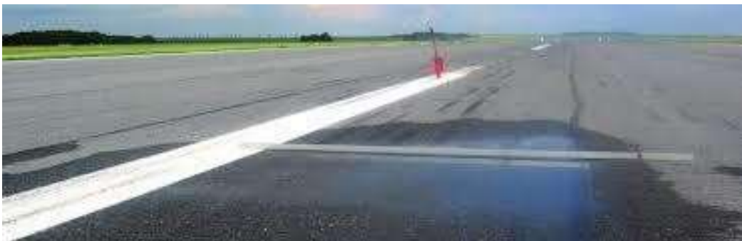
Figure I. 14: Route avec désordre du profil.
