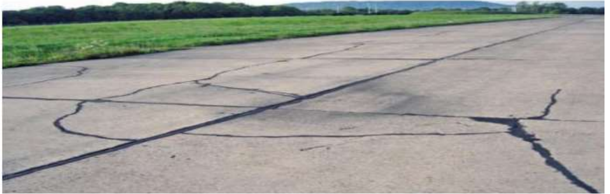
Figure I. 25: Pompage identifié par les dépôts de fines [2].
