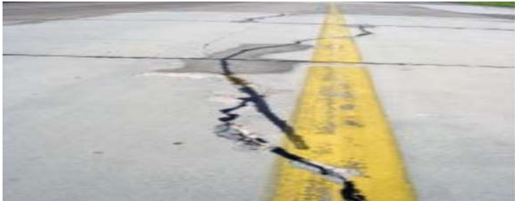
Figure I. 22: fissures au niveau de la chaussée [2].
