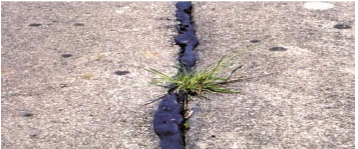
Figure I. 30: Défaut de joint [2].
