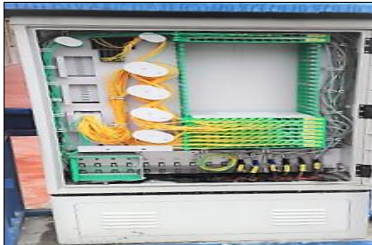
Figure II-9 Sous Répartiteur Optique
