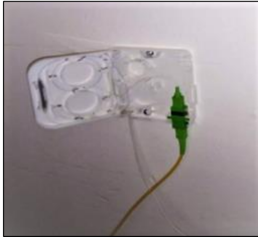
Figure II-11 Prise Terminal Optique.
