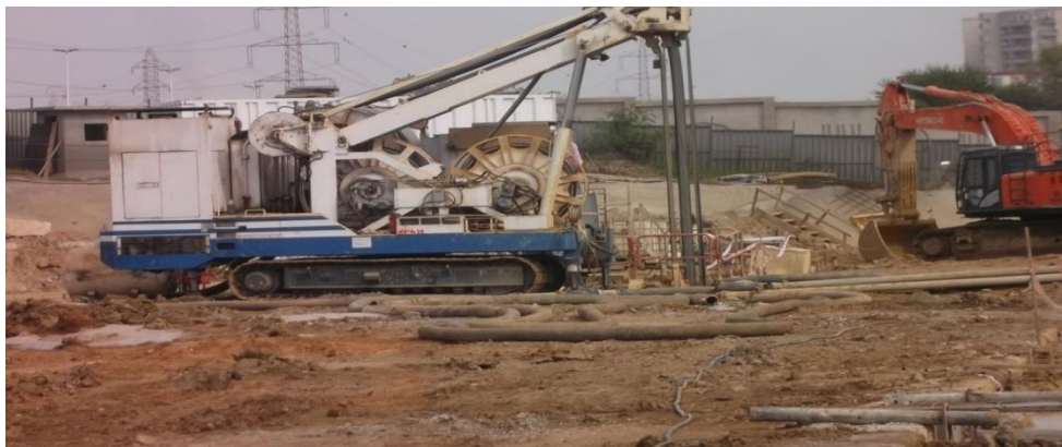
Figure 1.9 : Outil d'excavation d'une paroi moulée (Site de la station de l'université Houari Boumediene en Algérie)
