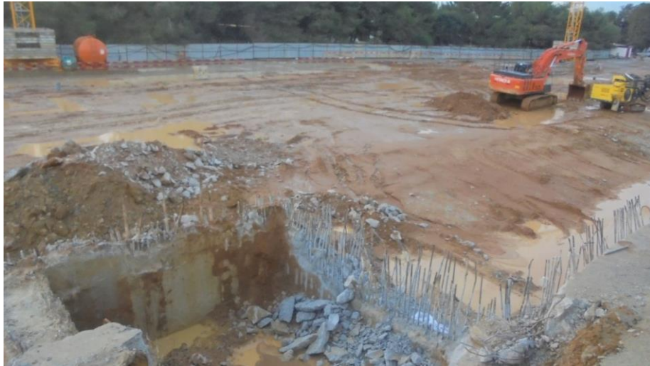
Figure 1.12 : Excavation des abords et enlèvement des murets guidant de la paroi moulée (Site de la station de l'université Houari Boumediene en Algérie)
