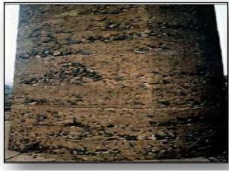
Figure VII. 13 : Abrasion du béton [1]
