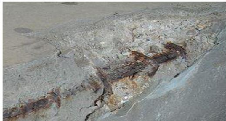
Figure VII. 25 : Éclatement du béton dû à la carbonatation. [1]
