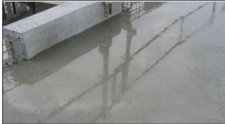
Figure VII. 8 : Ressuage du béton. [1]
