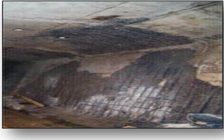
Figure VII. 11 : Béton après un incendie [1]
