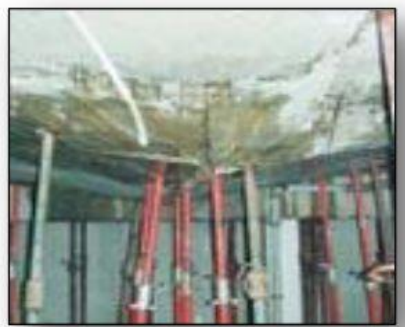
Figure VII. 15 : fissuration et éclatement du béton sous charges trop importantes [1]
