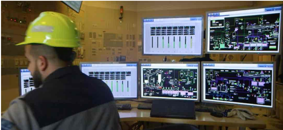
Figure 1.7 salle de contrôle et de commande
