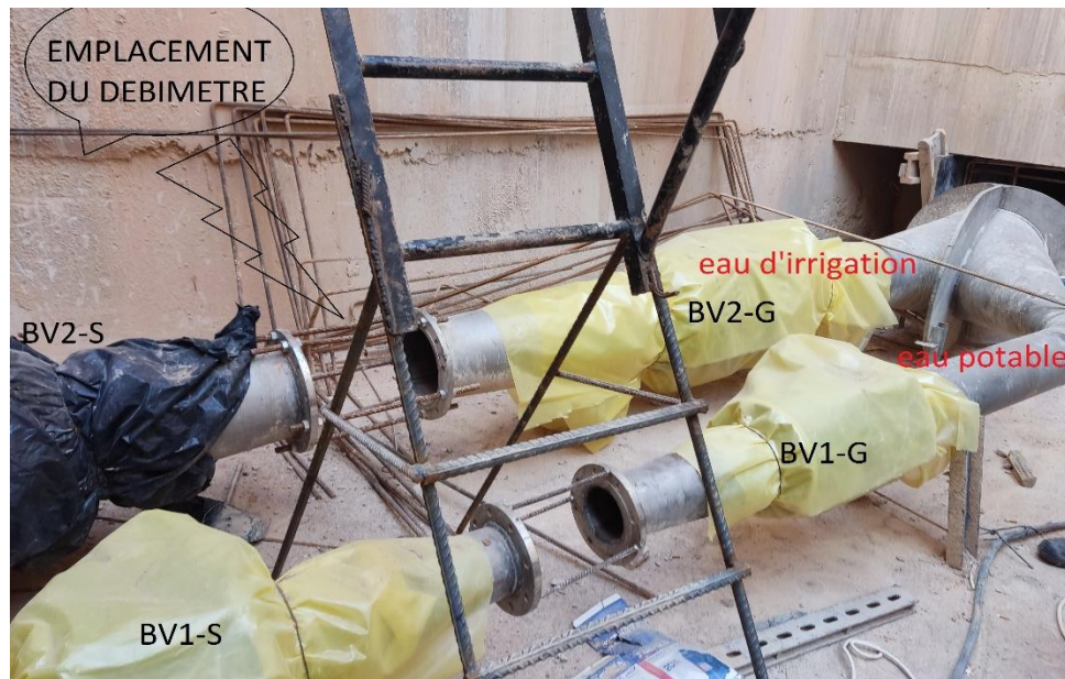
Figure 1.4 Vanne vidange de fond
