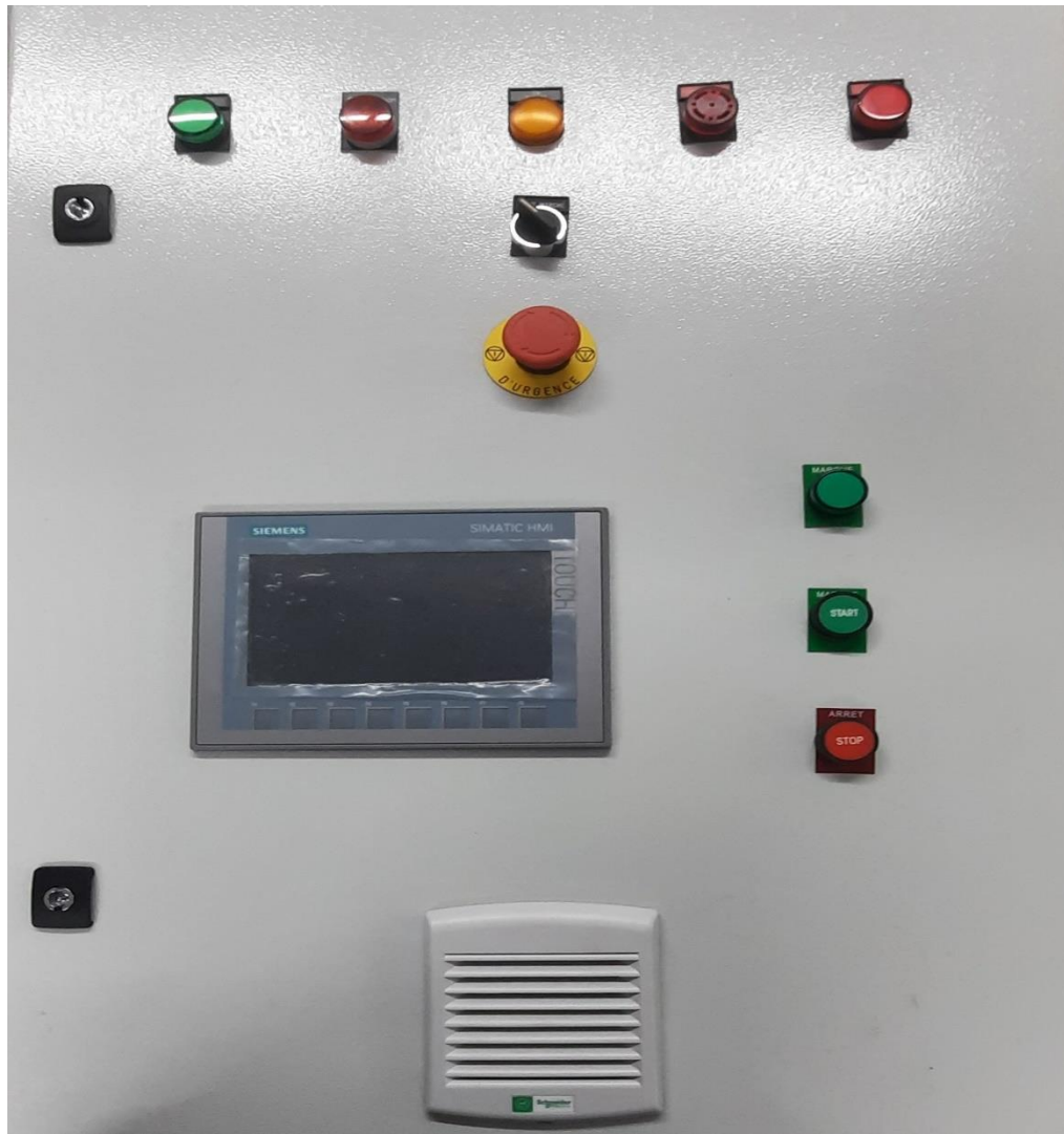
Figure IV.4 : L'armoire électrique de vue Externe
