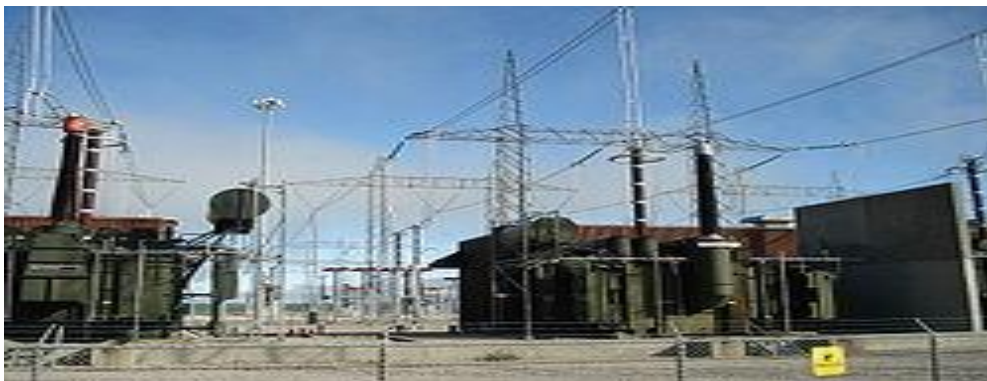
Figure 1-6 Transformateur à la centrale hydroélectrique
