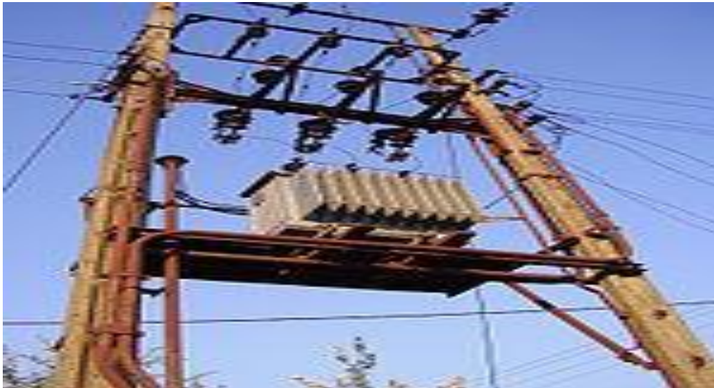
Figure 1-5 Transformateur de puissance.
