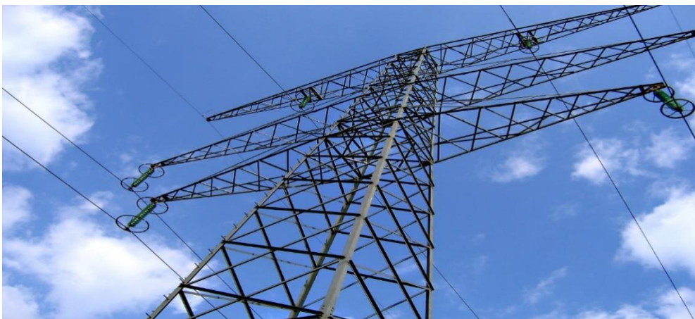
Figure 1-4 Les lignes électriques.
