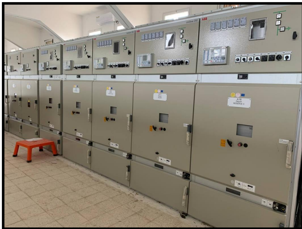
Figure 2.2 : Cellules d'un Poste HTB/HTA à Beni merad.
