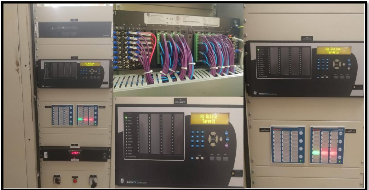
Figure 3.4 : Tranche générale du poste source Boufarik.
