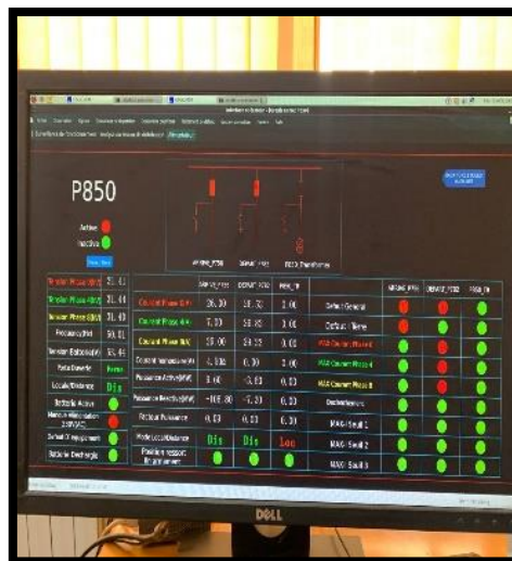
Figure 2.34 : poste MT/BT commander par GPRS.
