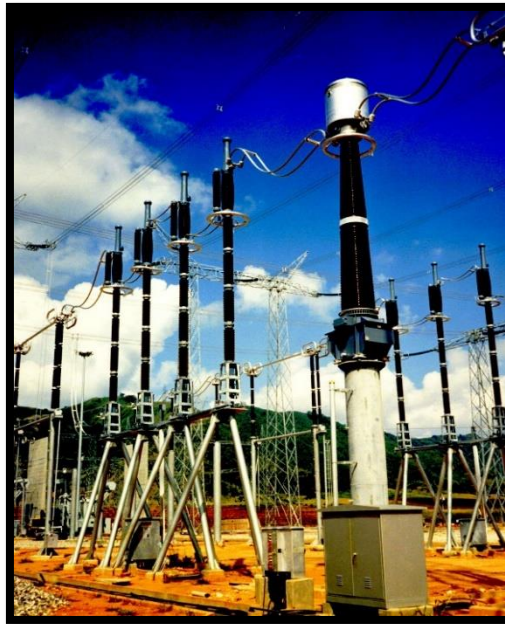
Figure 2.9 : Disjoncteur à haute tension.
