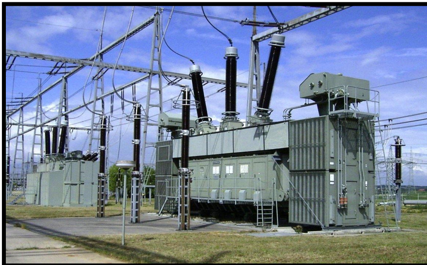
Figure 2.5 : Transformateur de puissance dans un poste électrique.
