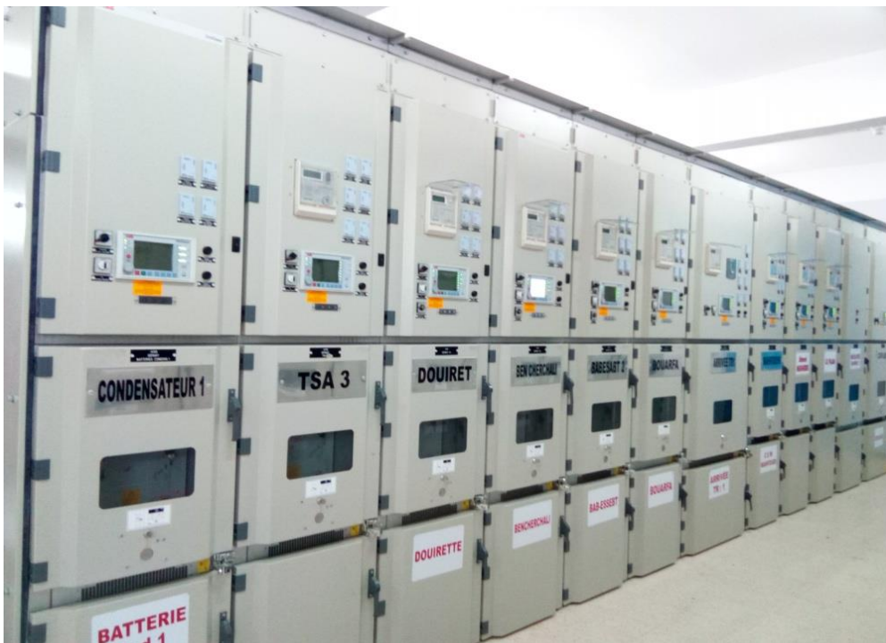
Figure II.9. Des parts au niveau de poste source SIDI KBIR.
