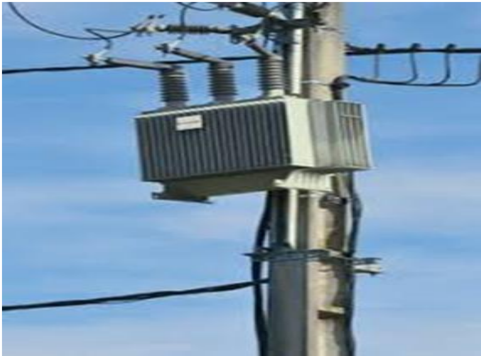
Figure II.6. Poste sur poteau dit H61.
